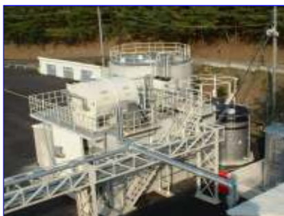
ますやみそ様メタン発酵設備
